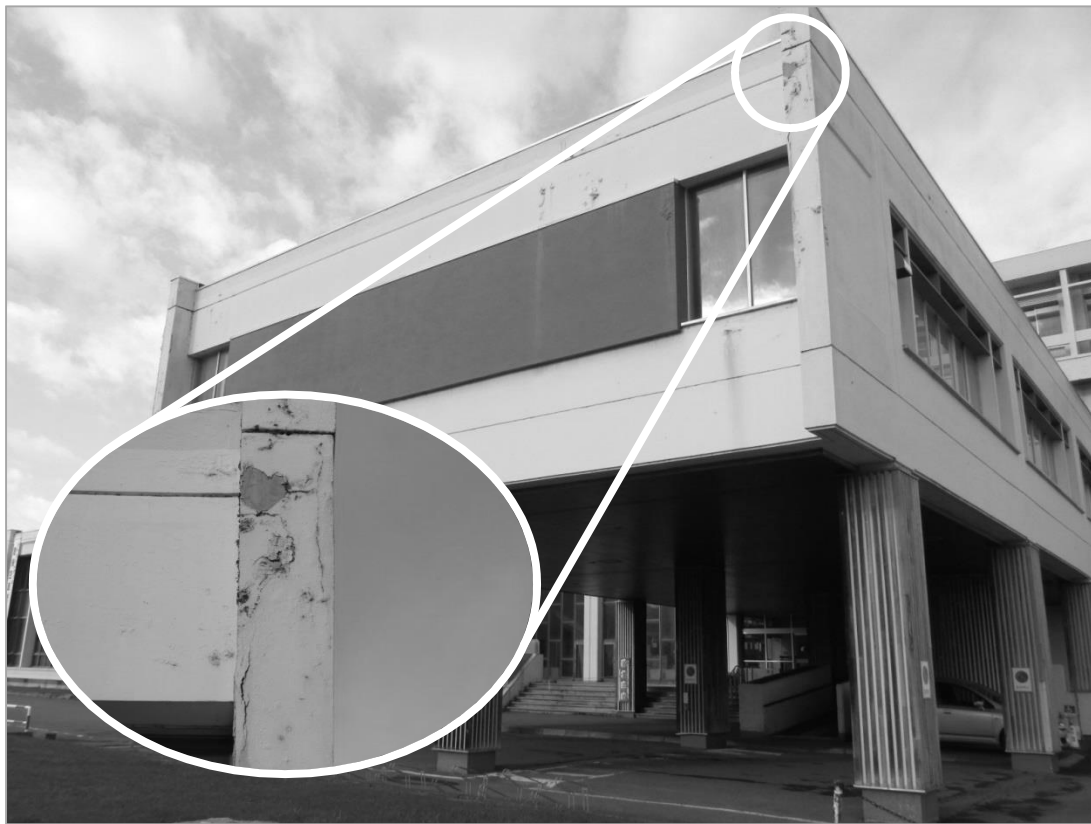
図 2. 2. 4 外壁の劣化状況（美唄市役所）
