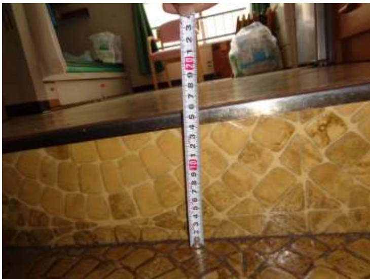
恵風園 居室入口の段差
