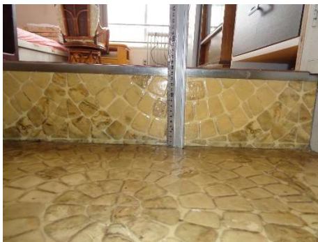
居室の床に段差がある(恵風園)
