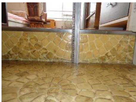
居室の床に段差がある(恵風園)
