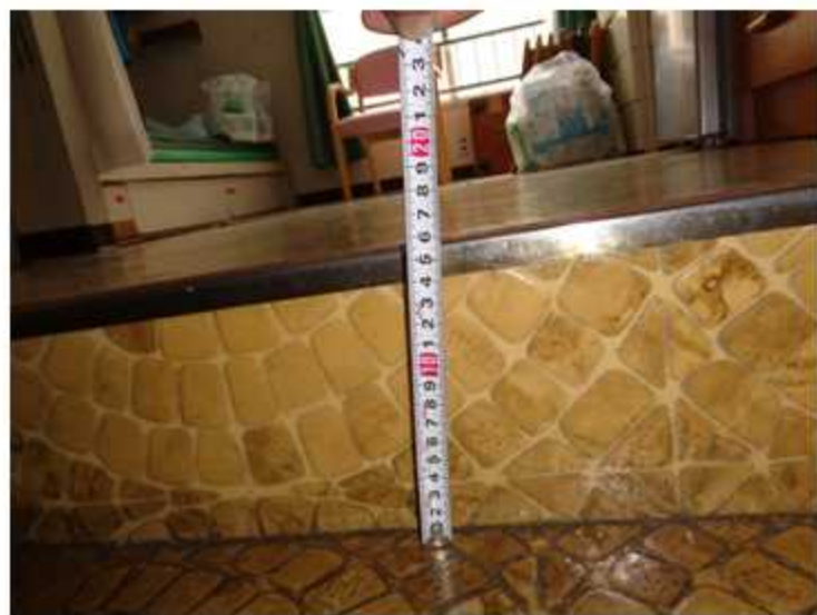
恵風園 居室入口の段差
