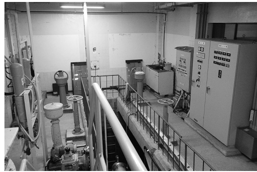
光珠内配水地内部
