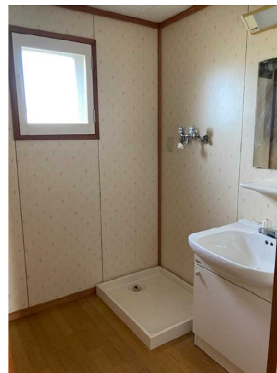
洗面・脱衣所
